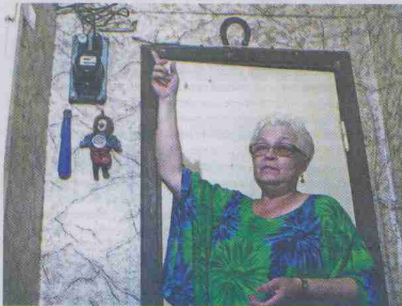
■ Наталья Кубарева, показывает электросчетчик в своей квартире. По ее мнению прежние жильцы квартиры пытались отремонтировать проводку здесь самостоятельно, либо прибегали к помощи непрофессионалов
